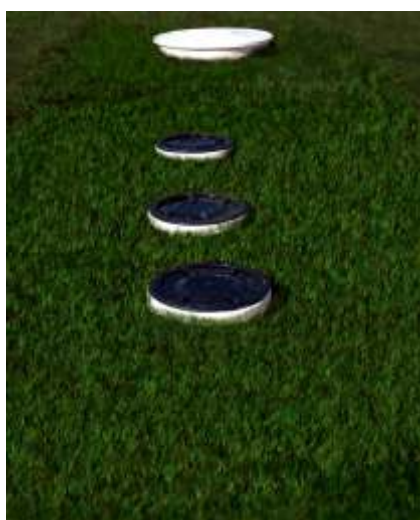
Filtro biológico para un centro canino en Jerez de la Frontera
